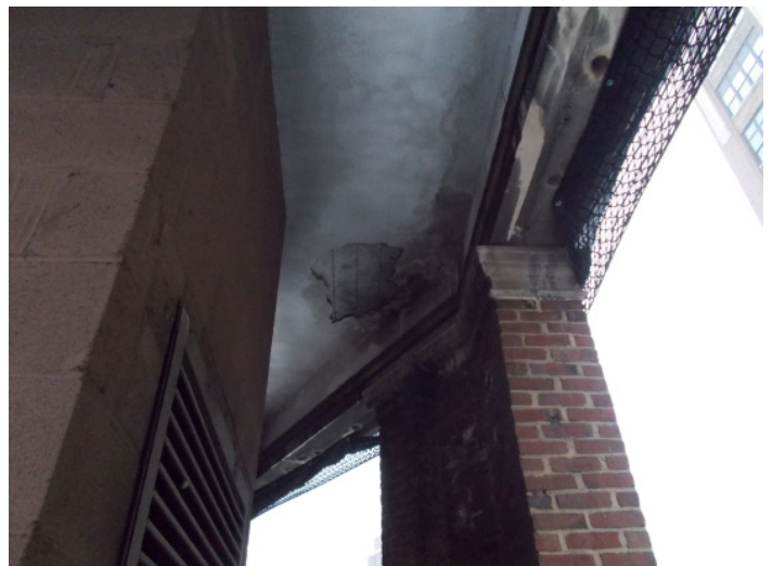
Spalling Stucco at Colonnade Loggia
